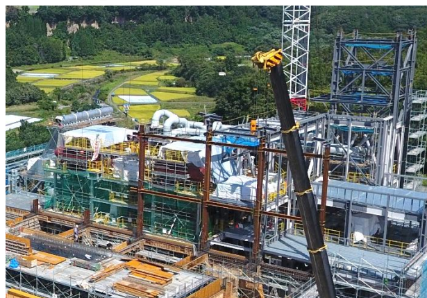
【写真②】プラントエリア
