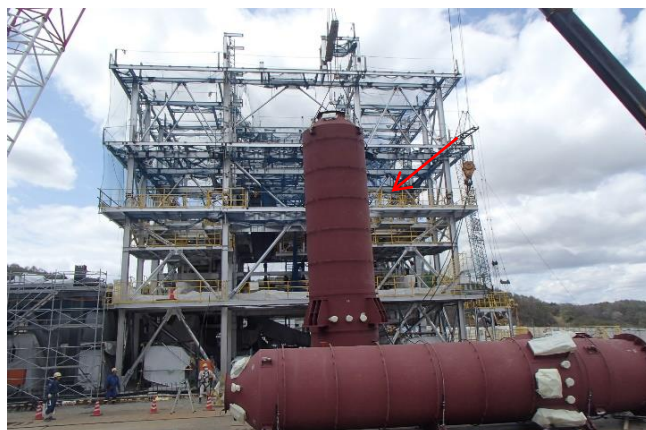
【写真④】 減温塔
