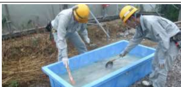
水素イオン濃度の監視及び中和処理
